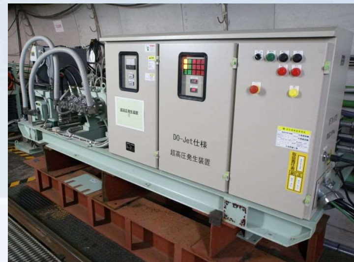
写真-2 超高压ポンプユニット
