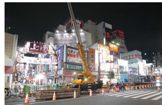
写真-2 車上プラント状況①
