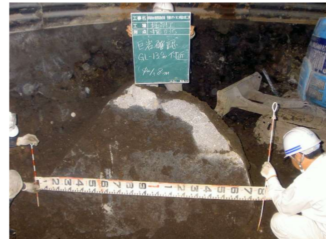
写真-4 中間立坑掘削時の巨石確認
