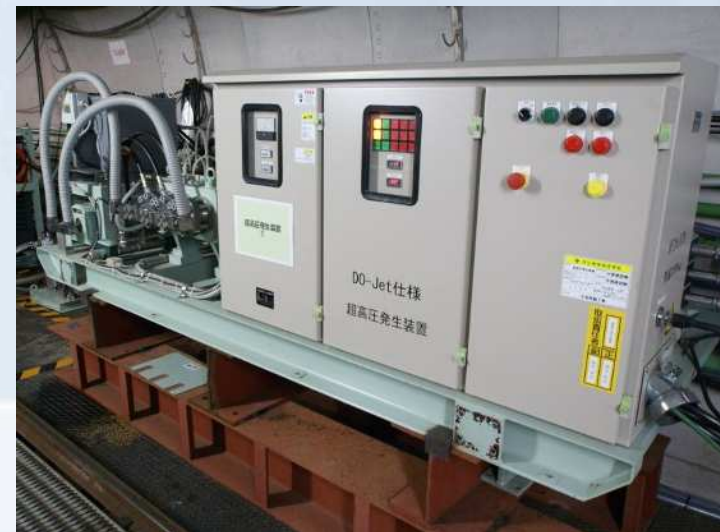
写真-2 超高压ポンプユニット
