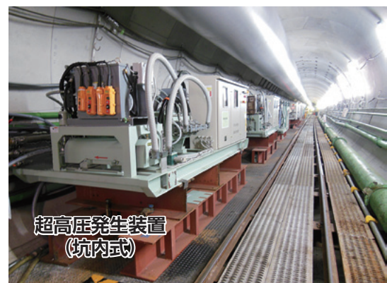
DO-Jet坑内設備
