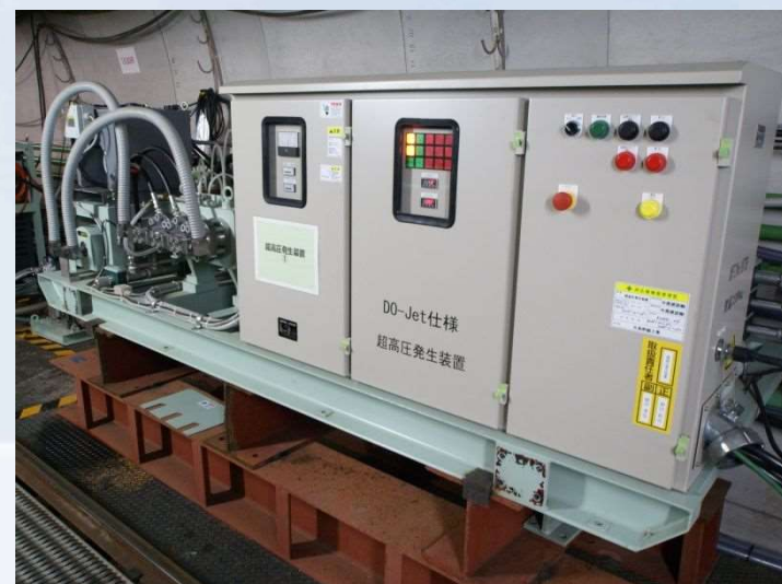
写真-2 超高压ポンプユニット
