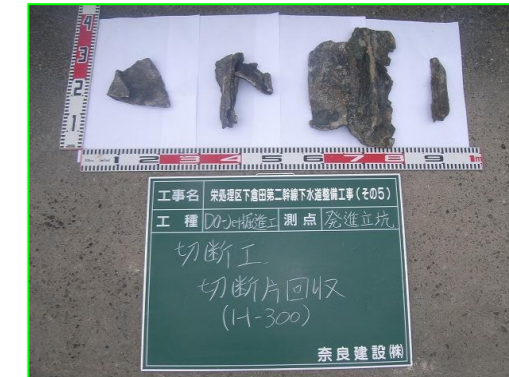
写真-1 回収したH形鋼切断片
